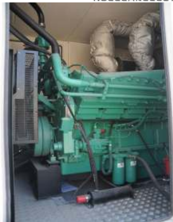
Figura 2-9 Generatoare electrice Diesel mobile
