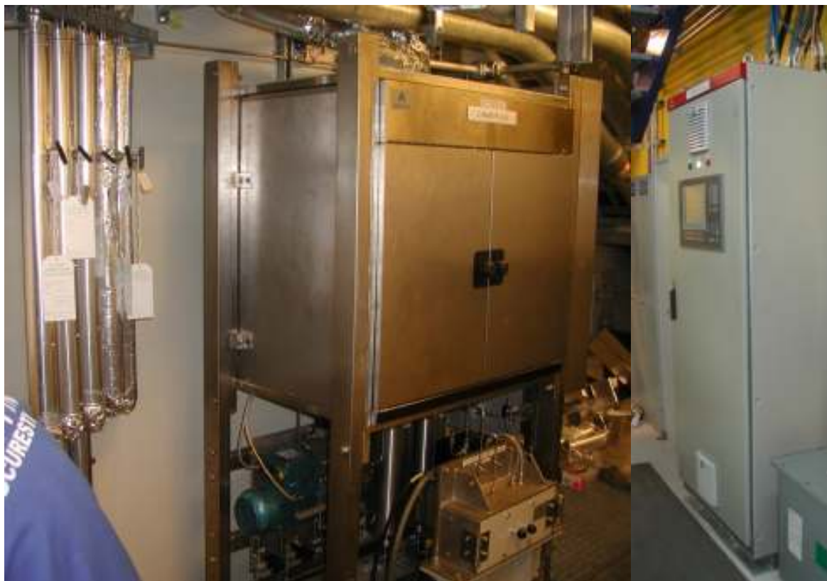
Figura 2-13 Sistemul de monitorizare a concentratiei de Hidrogen din Clarirea Reactorului
