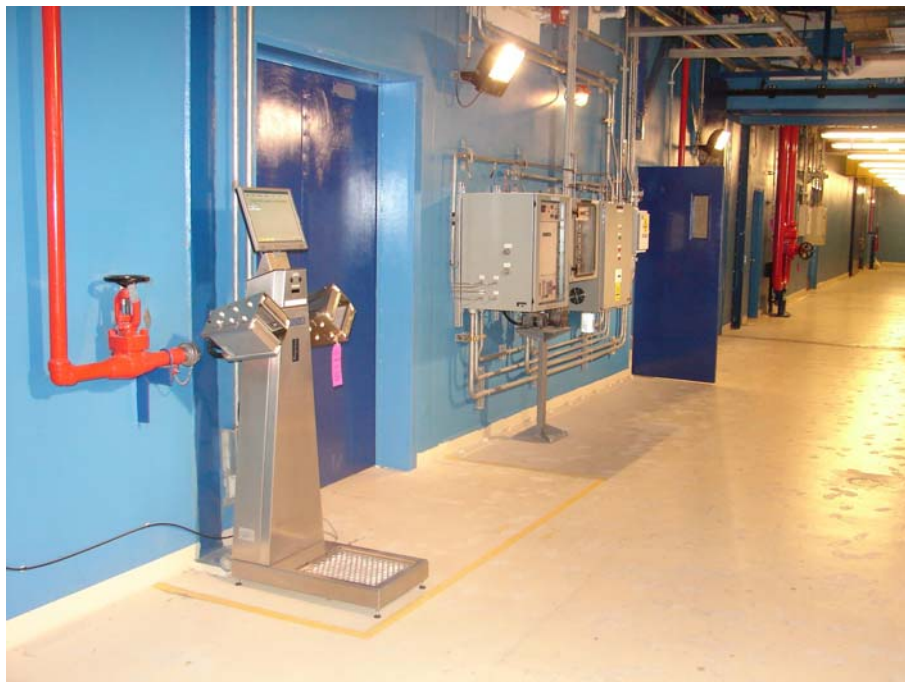
Fig. 3.2 Zonare radiologică în U2, monitor de contaminare fix inter-zonal, unitate de prelevare aer și panou local din sistemul de monitorizare tritii în aer
