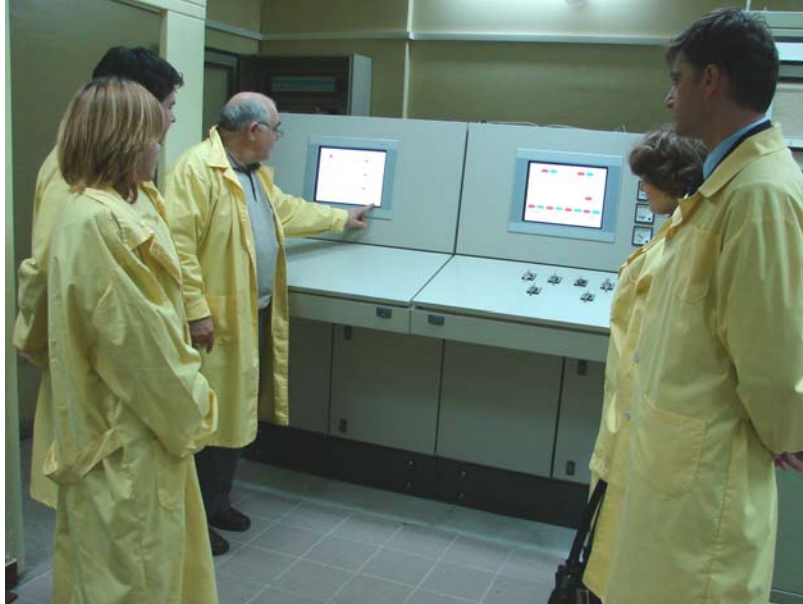
Fig.1.28 Inspecție CNCAN la Sistemul de control comandă al reactorului de cercetare TRIGA, SCN Pitești
