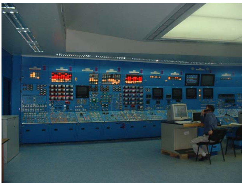
Fig. 2.5 Centrala nuclearo-elctrică Cernavodă, Unitatea 2, camera de comandă principală
